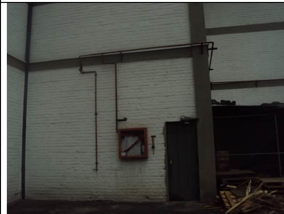
MANGUERA CONTRA INCENDIOS
