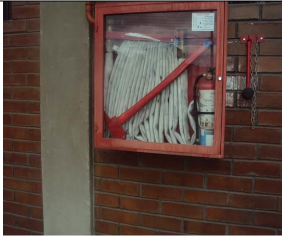
MANGUERA CONTRA INCENDIOS
